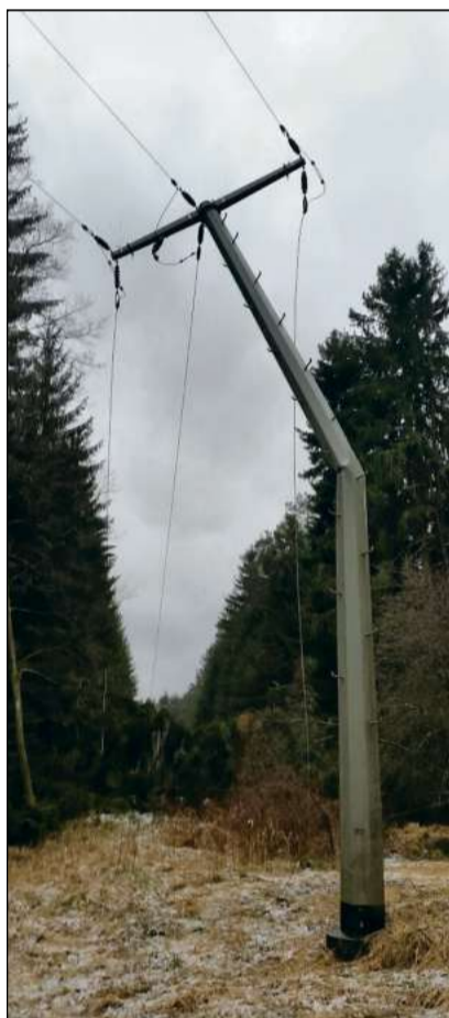
Notfall: In so einer Situation muss ein FBG-Trupp schnell vor Ort sein.
